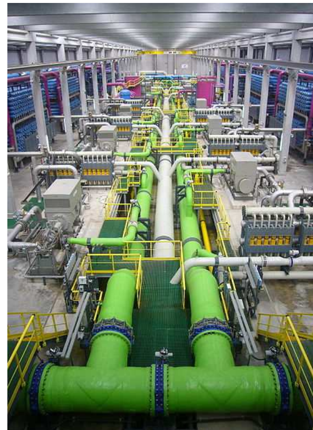
Anlegg for avsalting ved omvendt osmose í Barcelona , Spania
